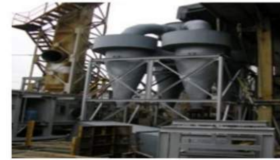
신대양제지 T,R,S및 CYCLONE
