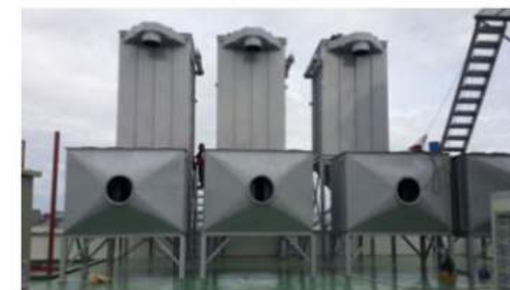
쓰리나인 집진설비 제작,설치
