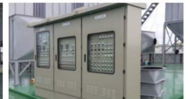
쓰리나인 집진설비 제작,설치
